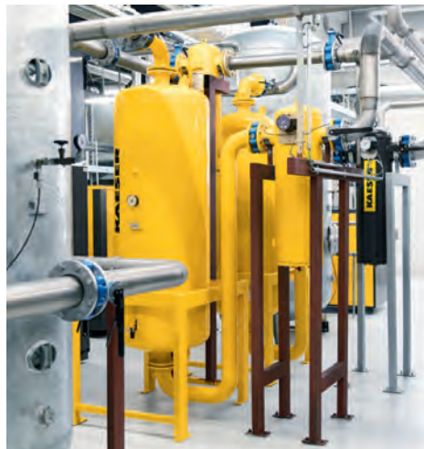
Новая система подготовки сжатого воздуха
