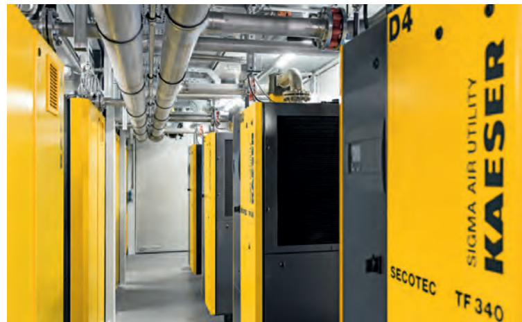
SIGMA AIR UTILITY от KAESER: слева: так выглядит станция внутри. справа: так выглядит станция снаружи.
