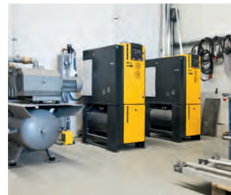
Компрессорная станция KAESER производит необходимый сжатый воздух
